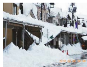
長岡市与板地区のアーケード倒壊
