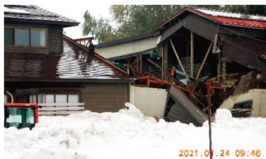
図1 建物の倒壊(上越市)
