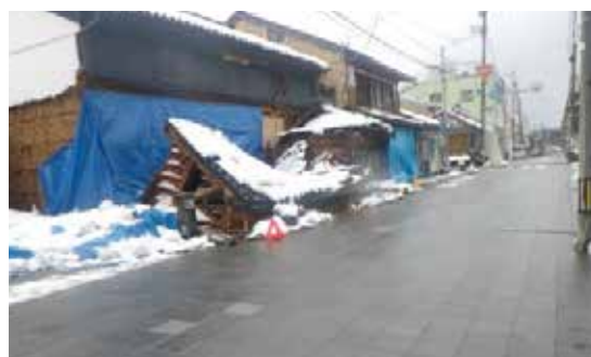
図4 地震による建物被害 七尾市
