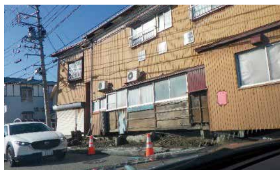
図2 液状化による建物被害 新潟市西区
